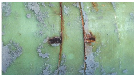
図 5-3 被覆材に傷を付けたことにより発生した 局所的な腐食の例
