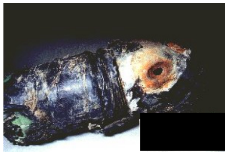
図 2-2 白管継手部に集中して腐食が発生し、穿孔した例
