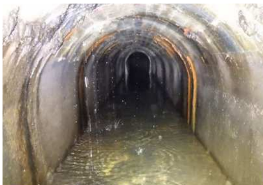
老朽化した水路トンネル
