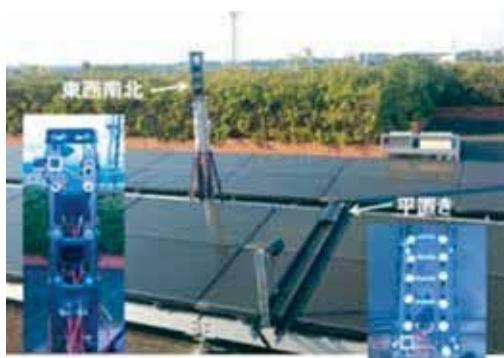
図1：海老名本部屋上におけるPSCモジュール屋外暴露試験の様子
