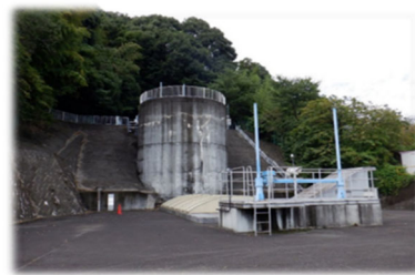
【柿生発電所の外観】
