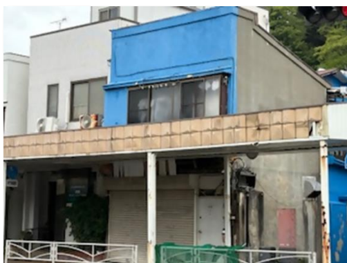
【老朽化したアーケード】
