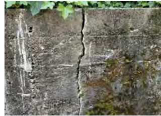
開いた亀裂 (表面)
