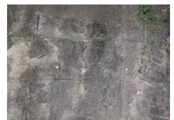
コンクリートのはがれ
