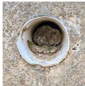
土砂の詰まり
