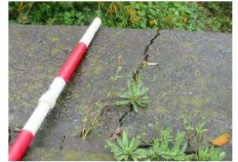
開いた亀裂 (頭部)
