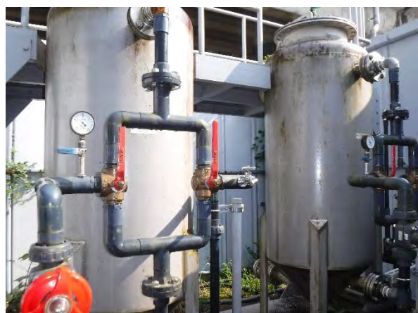
地下水汚染対策 (秦野市 浄化施設)
