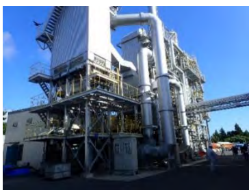
バイオマスボイラー
