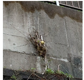
水抜き穴から植物
