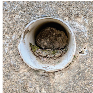
土砂の詰まり
