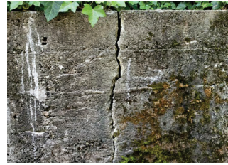
開いた亀裂 (表面)
