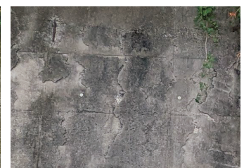
コンクリートのはがれ
