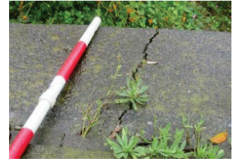
開いた亀裂（頭部）
