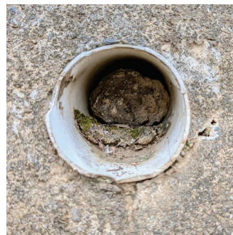
土砂の詰まり
