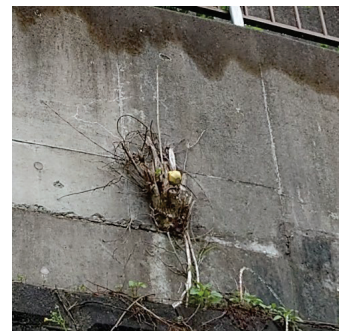
水抜き穴から植物
