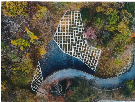
老朽化した林道法面施設の改良工事 (足柄上郡山北町玄倉地内 秦野峠線)
