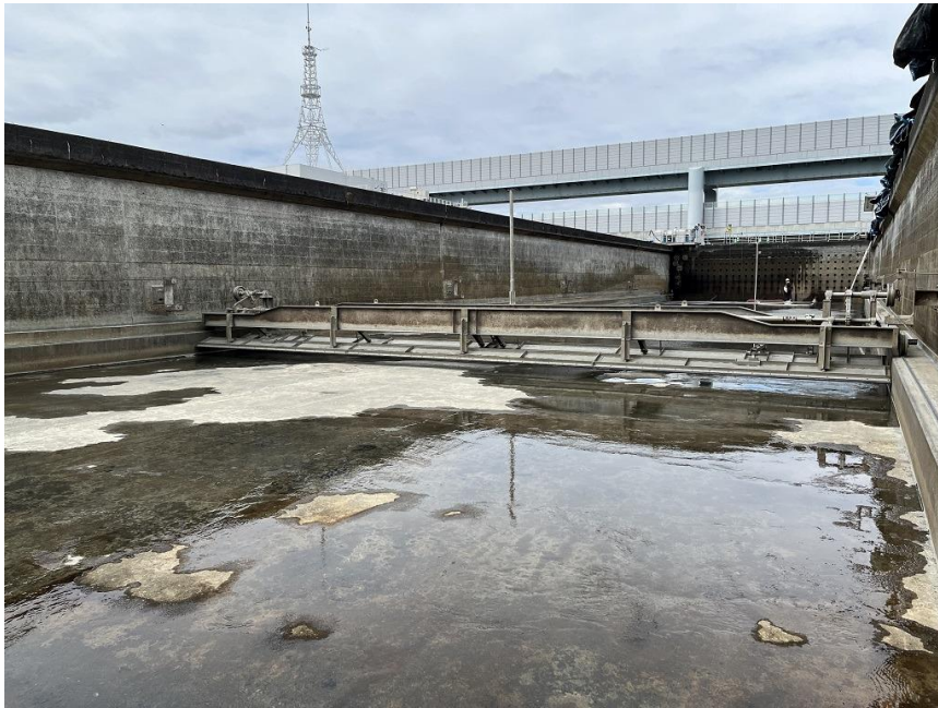
掻寄機(第2浄水場)
