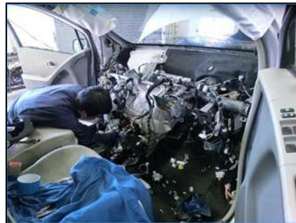
空調装置実習
