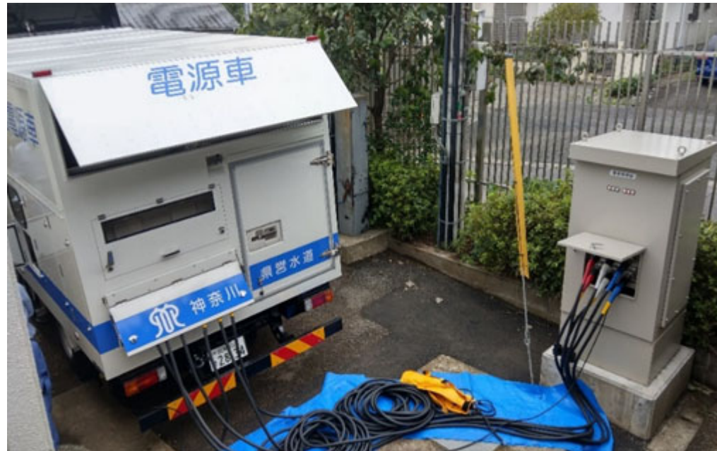
電源車に対応した設備
