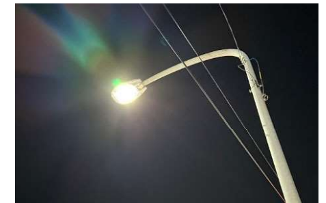
LED道路照明
