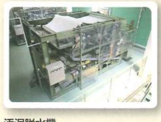
汚泥脱水機 メタン発酵槽の消化液を圧搾し、水分を取り除きます。
