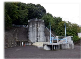
【柿生発電所の外観】
