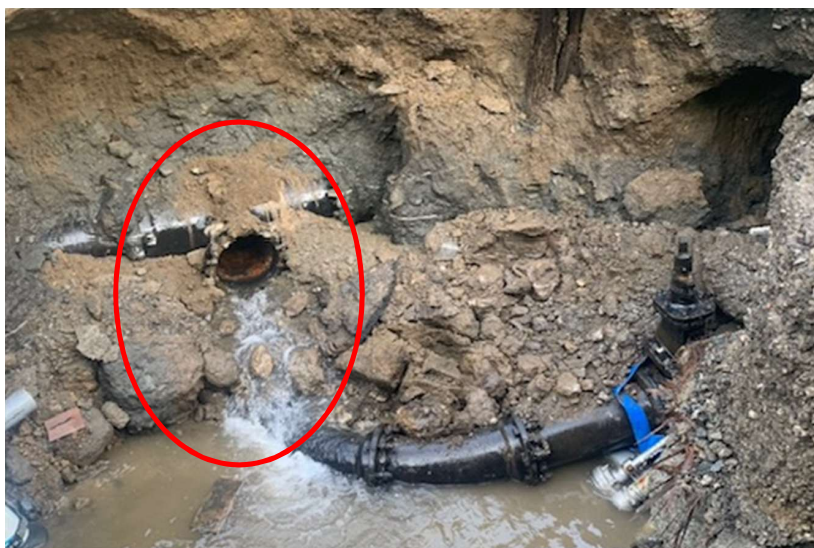
(図2 漏水箇所写真)
