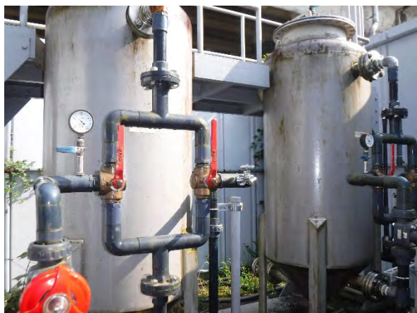
地下水汚染対策（秦野市 浄化施設）
