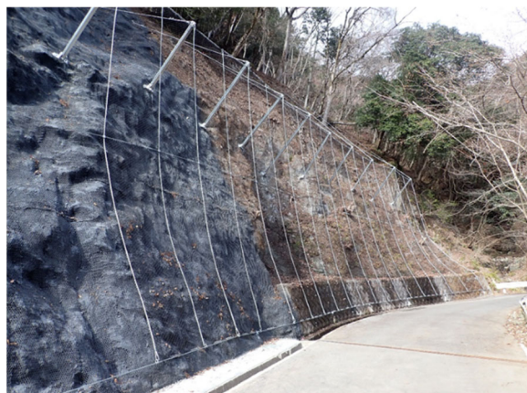
写真2-10 落石防止網（三廻部林道）
