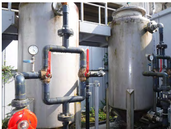
地下水汚染対策（秦野市 浄化施設）
