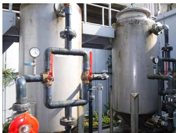
地下水汚染対策（秦野市 浄化施設）
