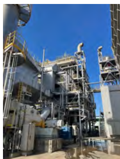
木質バイオマス発電所 （横須賀市）
