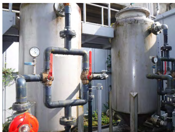
地下水汚染対策（秦野市 浄化施設）
