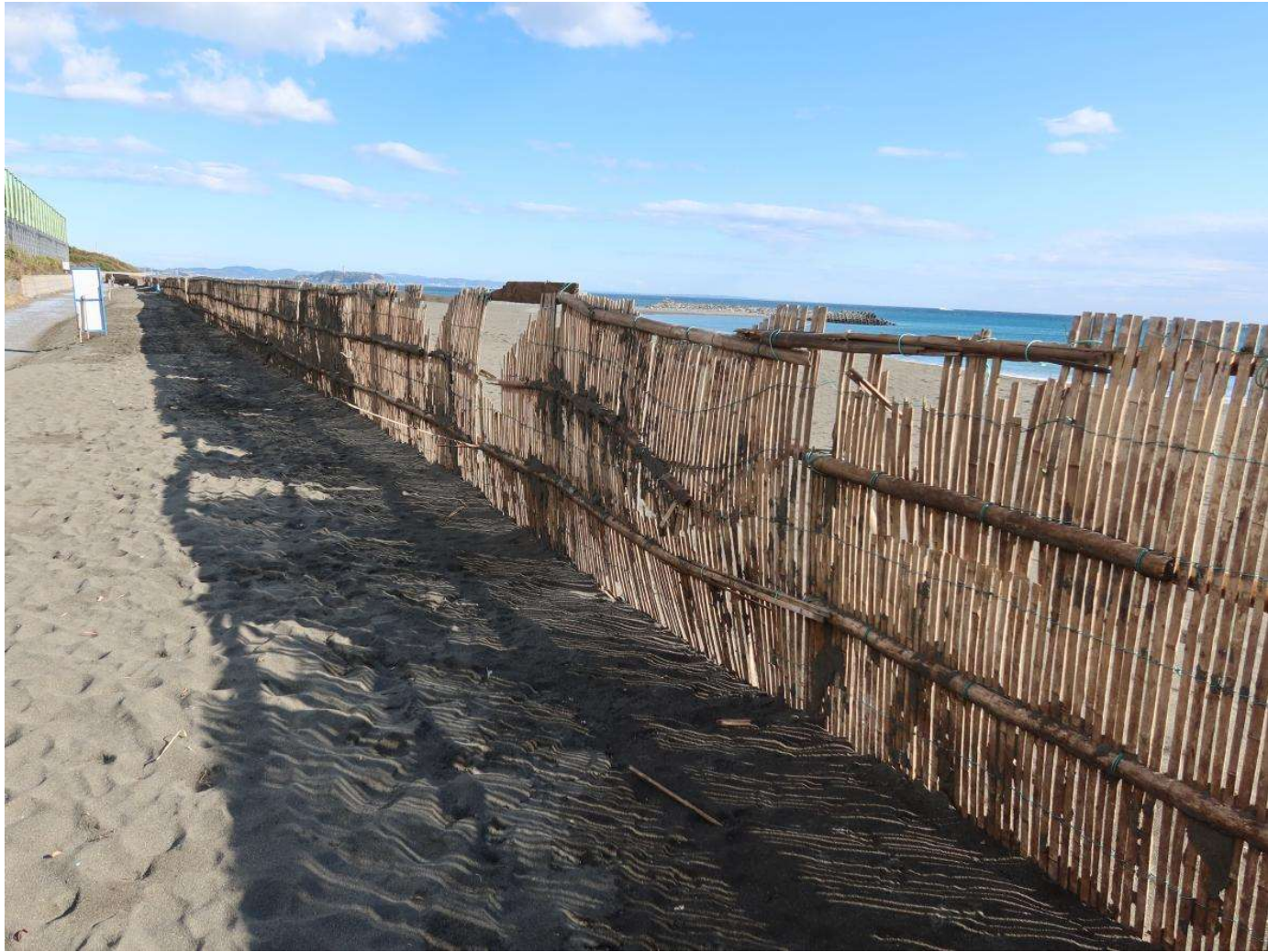
写真-10 破壊された堆砂垣
