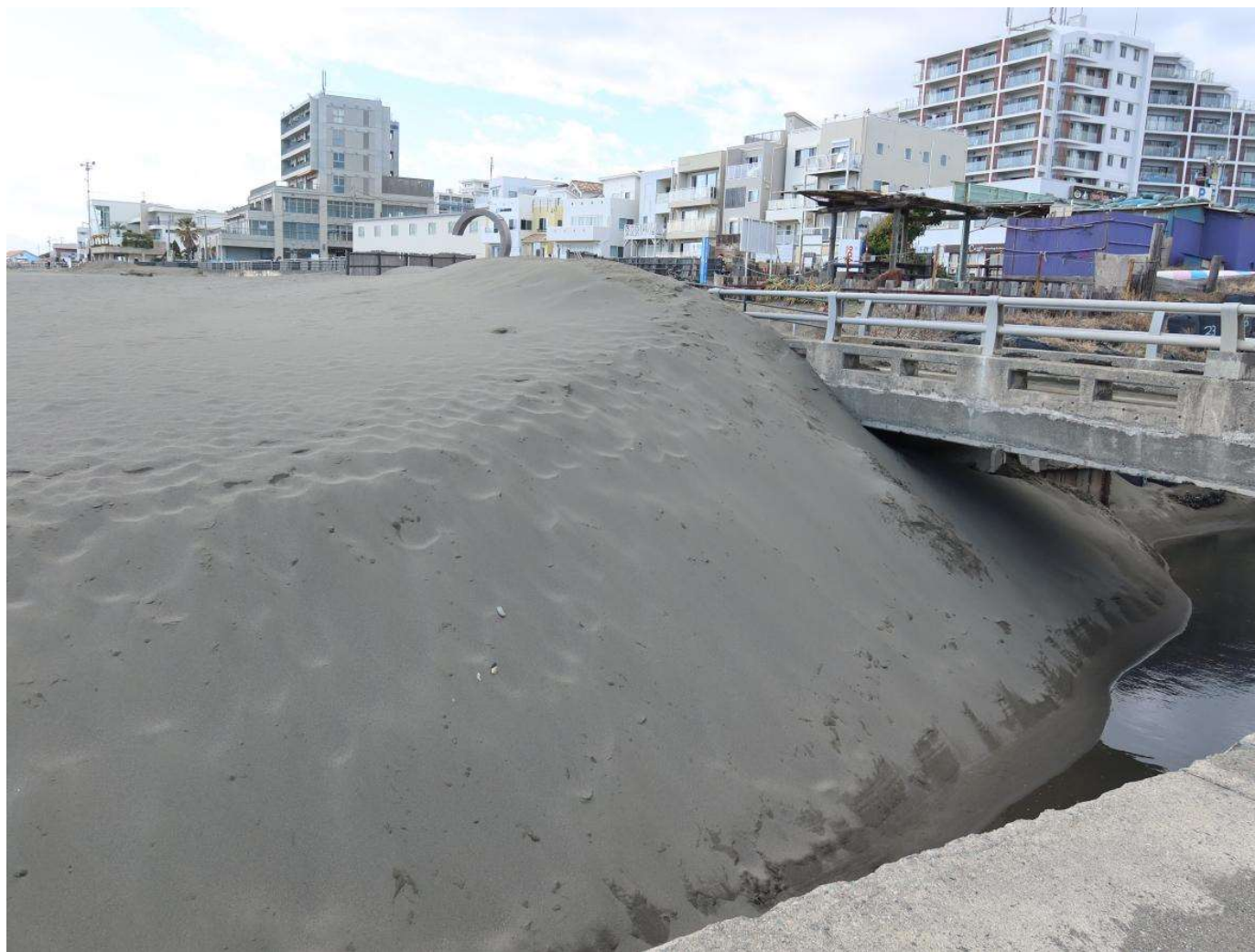
写真-2 6号水路に架かる橋の1/2を埋めるまでうず高く堆積した飛砂
