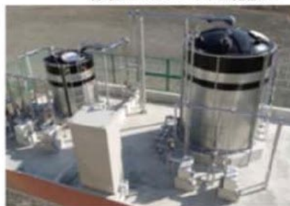
【生活排水対策：山梨県内の下水処理場に設置したリン処理施設の一部】
