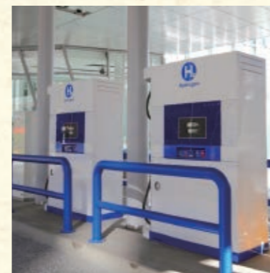
水素ステーション
