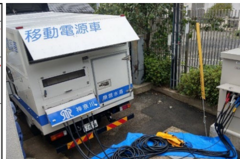
移動電源車に対応した設備
