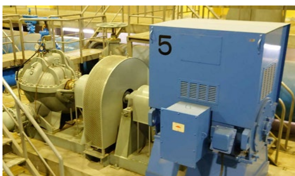
ポンプ設備 (稲荷ポンプ所)
