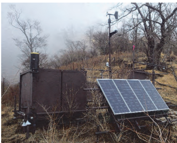
図1 気象観測施設の状況(檜洞丸)
