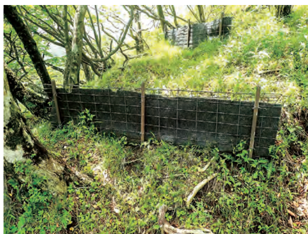
写真5. 吸出防止材（不織布）を設置した改良型金網筋工（大室山、2021年6月21日撮影）
