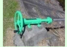
ゲート、バルブの更新
