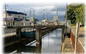
老朽化した水門
