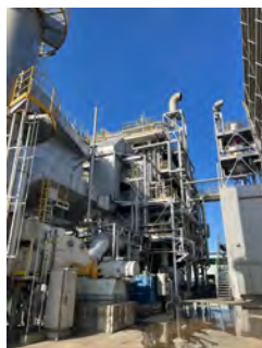
木質バイオマス発電所 （横須賀市）
