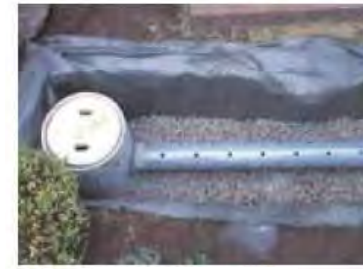
雨水浸透トレンチ
