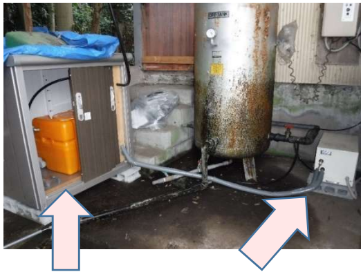
給水タンク 自給式ポンプ
