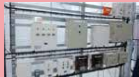
環境制御装置
