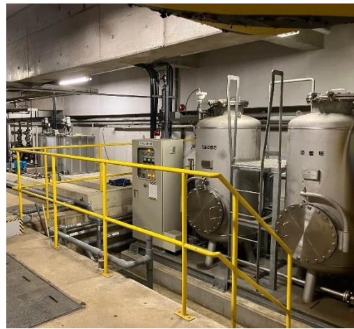
写真6 排水処理装置
