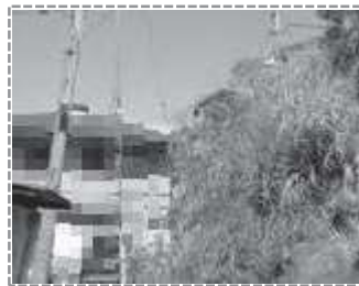
かけ高 10m未満の未整備斜面状況
